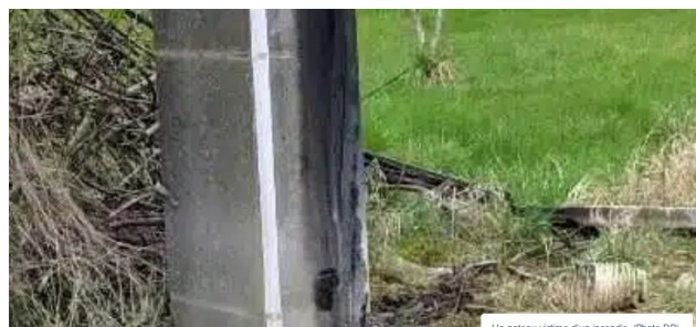
Un poteau victime d'un incendie. (Photo DR)
